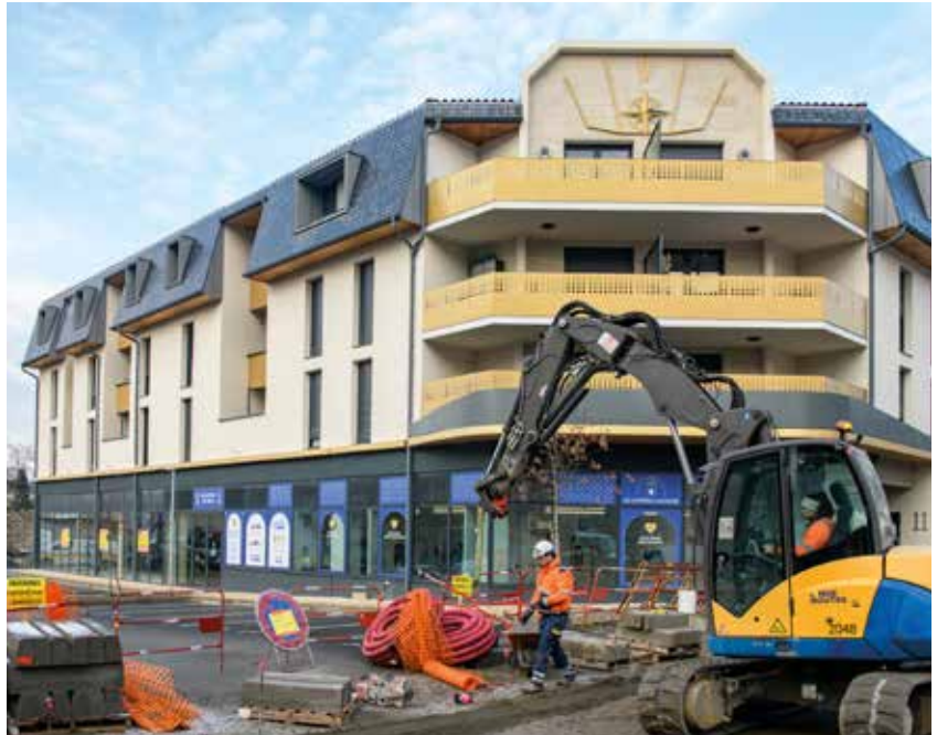
Les travaux de l'Agora village avenue du Maréchal-de-Lattre-de-Tassigny avancent à grands pas.
