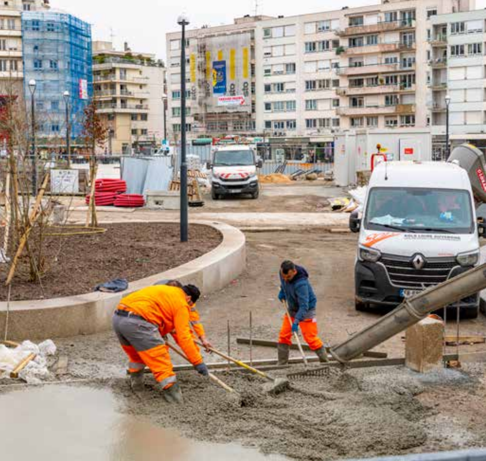
Le coulage du béton place Fournier marque la fin des travaux du site. En arrière plan, les premiers échafaudages sont montés pour procéder au ravalement de plusieurs immeubles de la place
